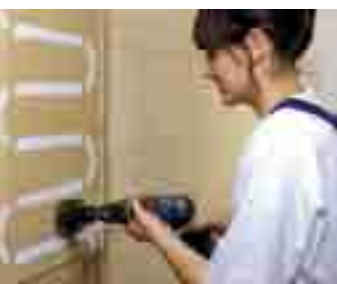
Unterputz-Steckdosen sind jederzeit möglich
